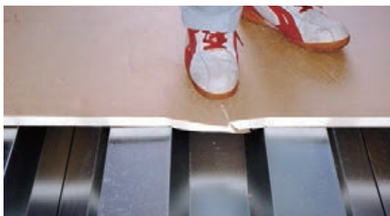
断熱材の踏抜き: Aデッキ
