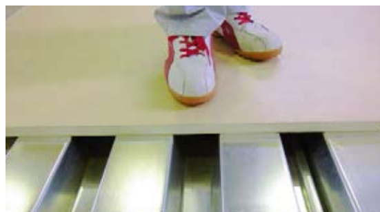
断熱材の踏抜き: 北日デッキ
